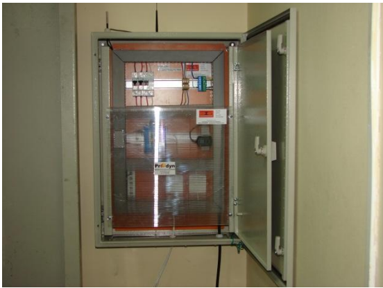
Caja contenedora de dispositivos de transmisión de datos.
